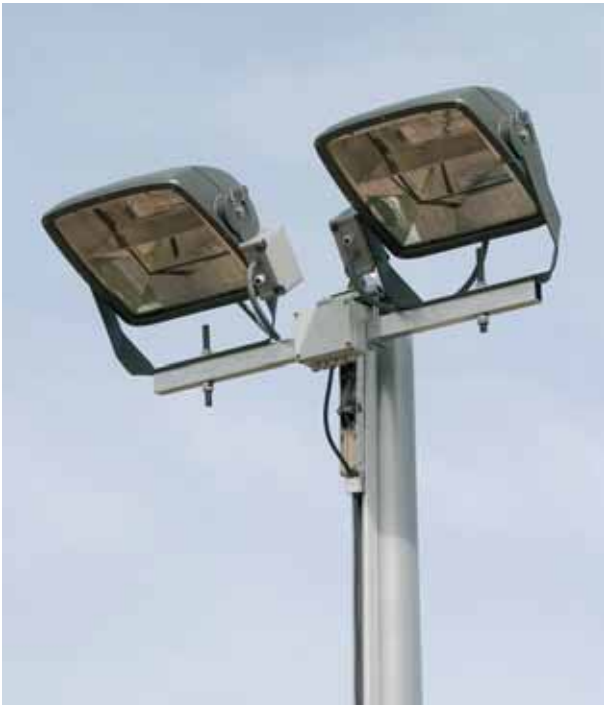
Application d'éclairage avec projecteurs
